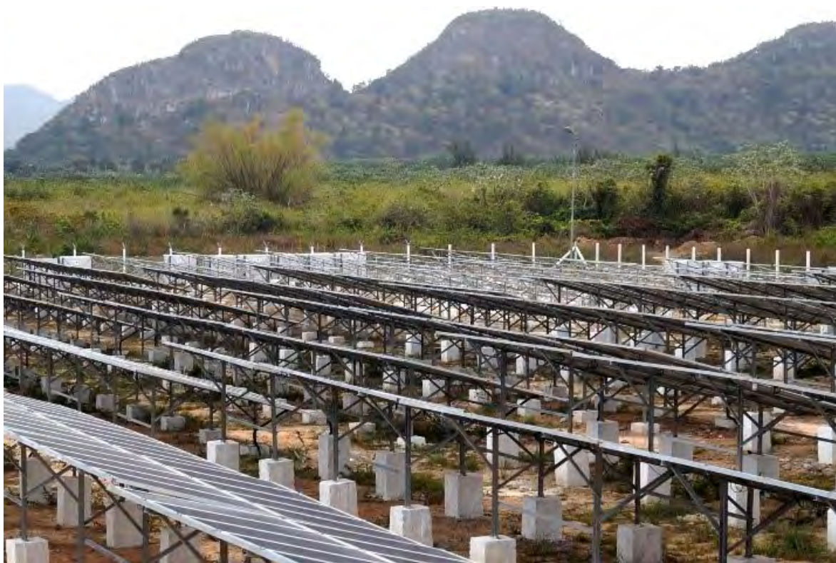
Fig. 20. Parque fotovoltaico «Los Colonos».
